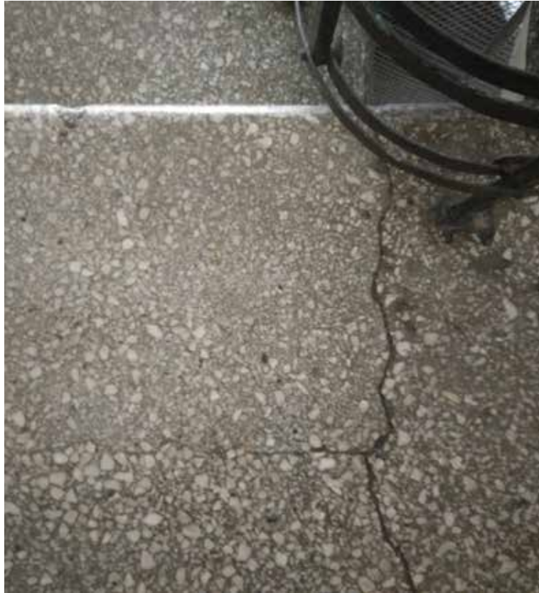
Porrashuoneen betoniaskelma erottuu halkeamien avulla lepotason mosaiikkibetonista. (Kuva: RL)
