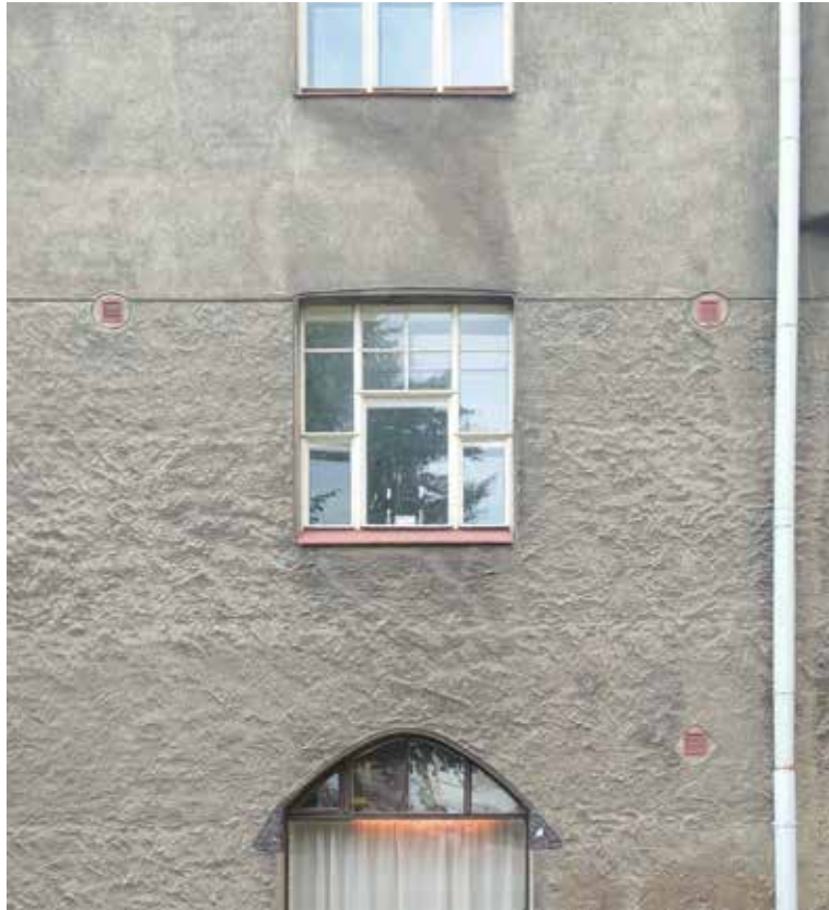
Rappauspinta on ylemmissä kerroksissa käsitelty sileämmäksi kuin alemmissä. (Kuva: RL)
